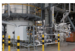
副生油外販用設備
