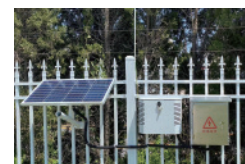
無組織排ガス監視オンライン設備
