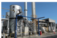
CNLを使用しているボイラ
