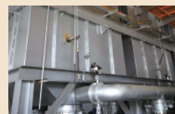
RTO(蓄熱燃焼式排ガス処理装置)
