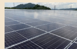
電力を利用している社外の太陽光パネル
