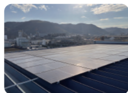
太陽光発電設備の導入
