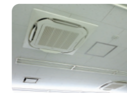
省エネルギータイプの空調設備の更新
