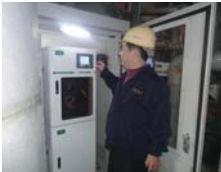
排水処理のCOD自動測定装置
