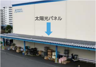
倉庫建屋に設置された太陽光パネル (大阪工場)
