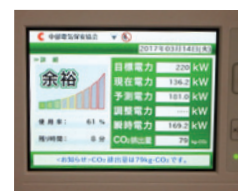
デマンド監視装置
