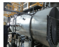
焼却炉排熱ボイラー
